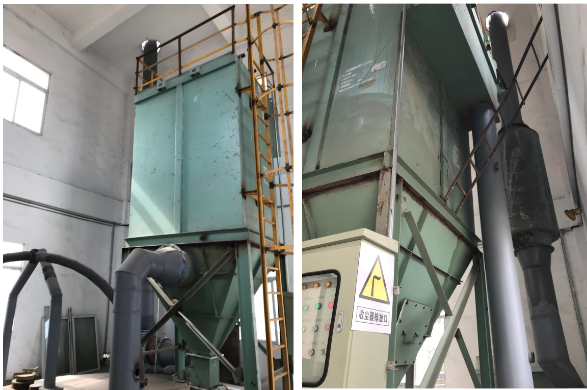
飞灰车间除尘设施及排气筒
