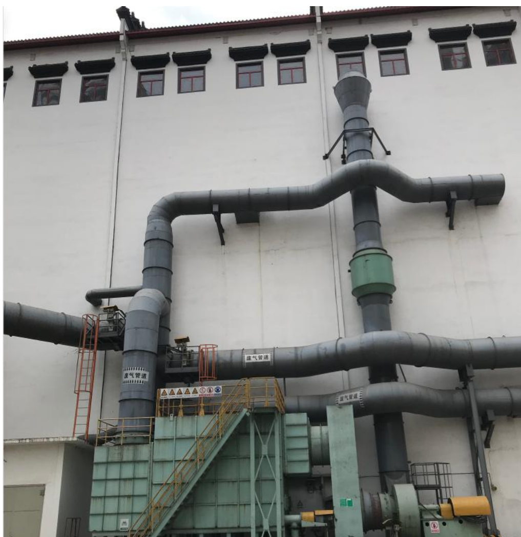
1#预处理车间废气活性炭吸附装置及排气筒
