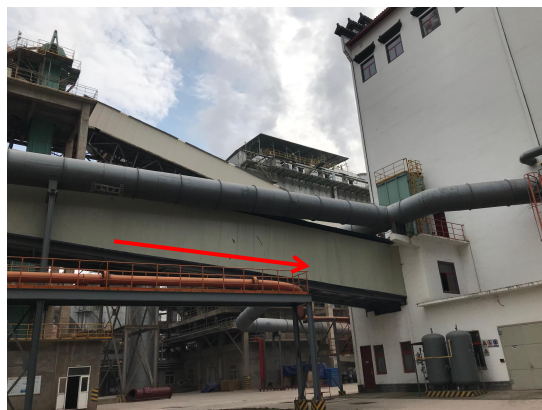
废液车间与2#预处理车间废气连通管
