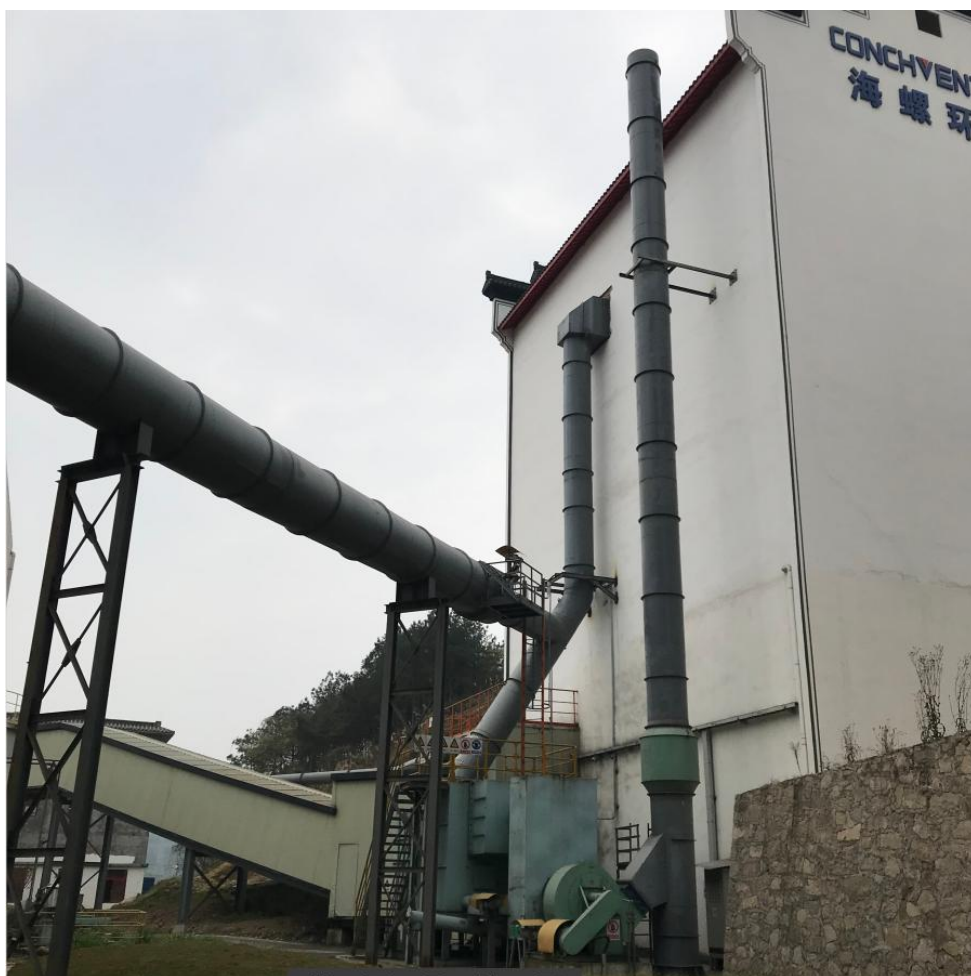
无机固废车间废气活性炭吸附装置及排气筒
