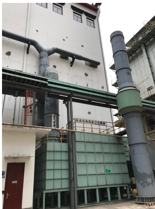
2#预处理车间废气活性炭吸附装置及排气筒
