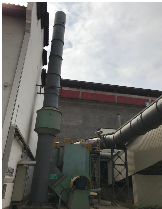
1#和 2#暂存库废气活性炭吸附装置及排气筒
