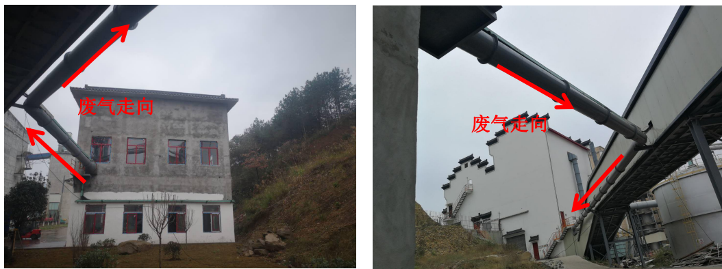
图 3.19 废包装物破碎车间负压收集系统
